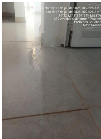
Imagem 04 – Pisos com infiltração
